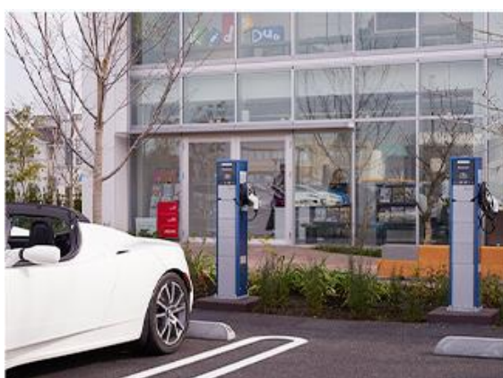
Figura 24 – Ponto para carregar veículos elétricos do FSST. Fonte: FSST (2025).
