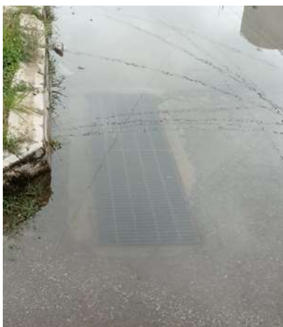
Figura 2. Rejilla sumergida como resultado de pozo azolvado. Fuente: Elaboración propia.
