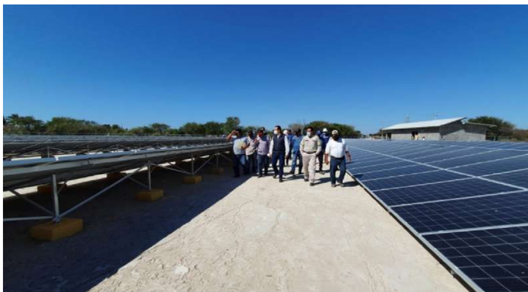
Figura 15. Planta solar en Santa María del Mar, Istmo de Tehuantepec, Oaxaca.
